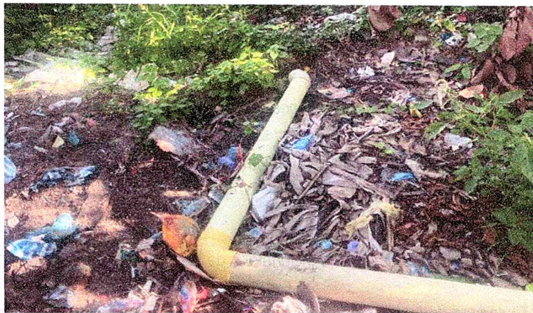
Figura. N°2. Descarga de aguas residuales domésticas.
